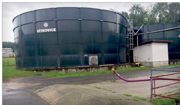
K uskladnění kejdy slouží ještě původní nadzemní nádrže
